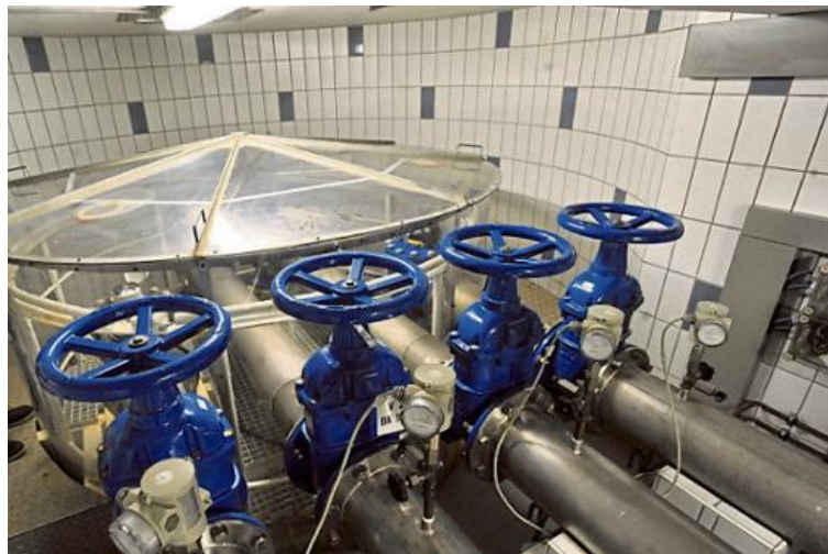
Das Brunnenhaus im Wasserwerk Rheindorf (Ralf Krieger)
